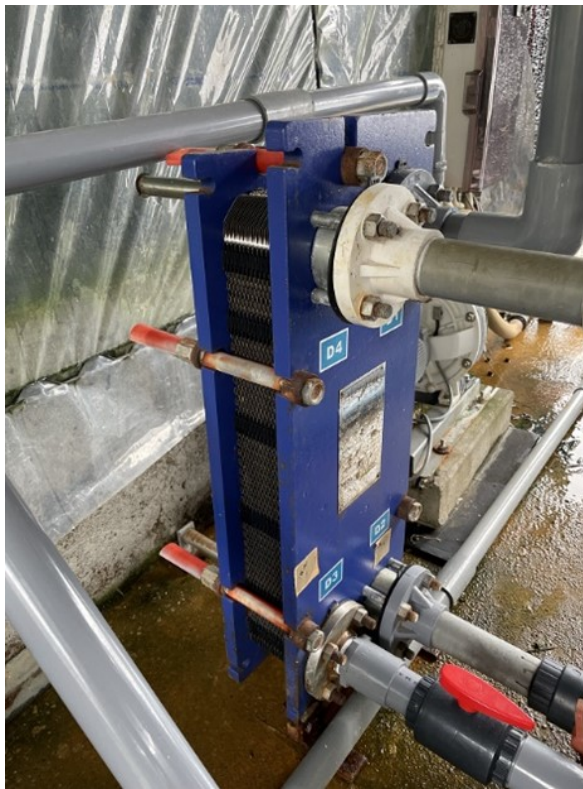
(養殖現場で使用している熱交換システム)
