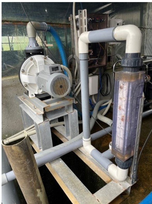
（養殖現場で使用している高濃度酸素発生装置）
